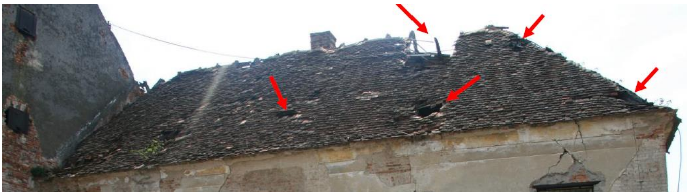
Obr. 2.: Keramická krytina v dezolátnom stave - exteriér (Zdroj: Vladimír Kohút, Lukáš Kramarčík)
