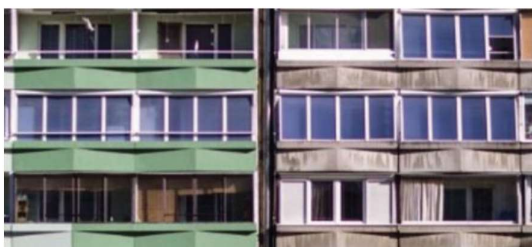
Obr. 1 Neregulované zasklievanie fasády bytového panelového domu v Petržalke (Zdroj: SME, 2020)
